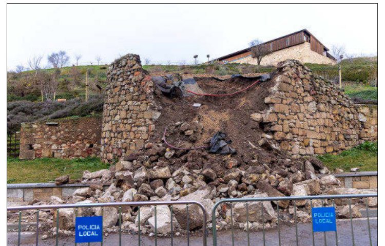
El derrumbe de un muro en la Vagua de la Palma de Salamanca. ICAL
